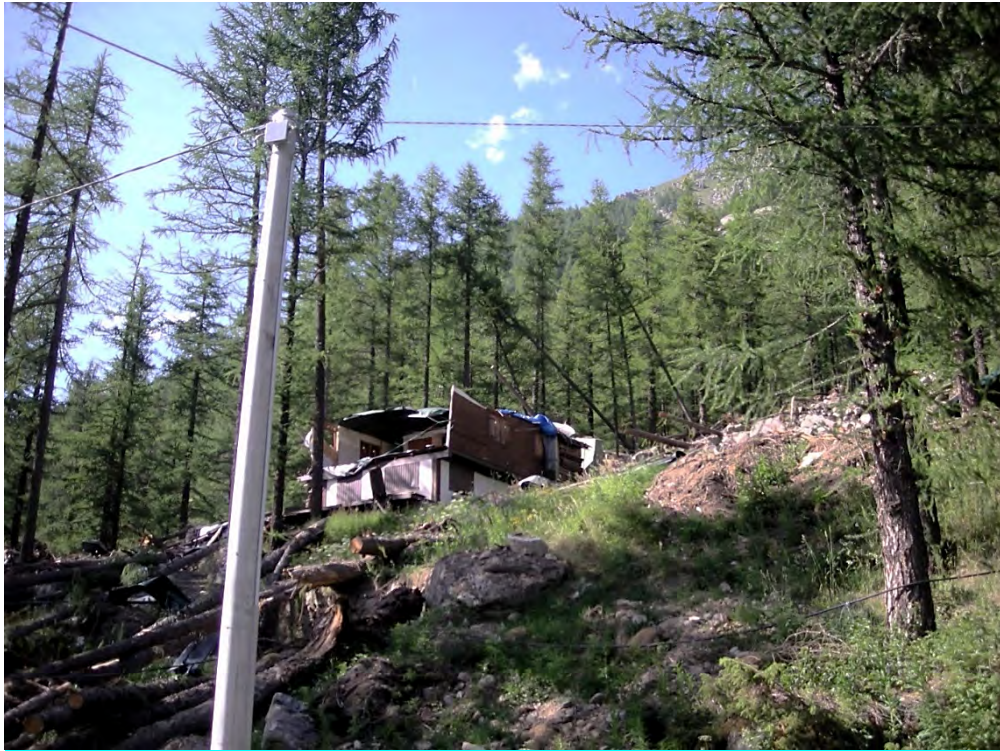
Figura 2.5 - Danni da valanga su edificio: è possibile osservare la completa asportazione della copertura. Ceresole Reale, Piemonte (Chiambretti, 2009).
